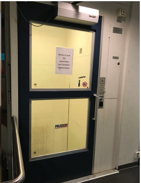
Heis fra 1. til 2. etasje ved inngang B.
