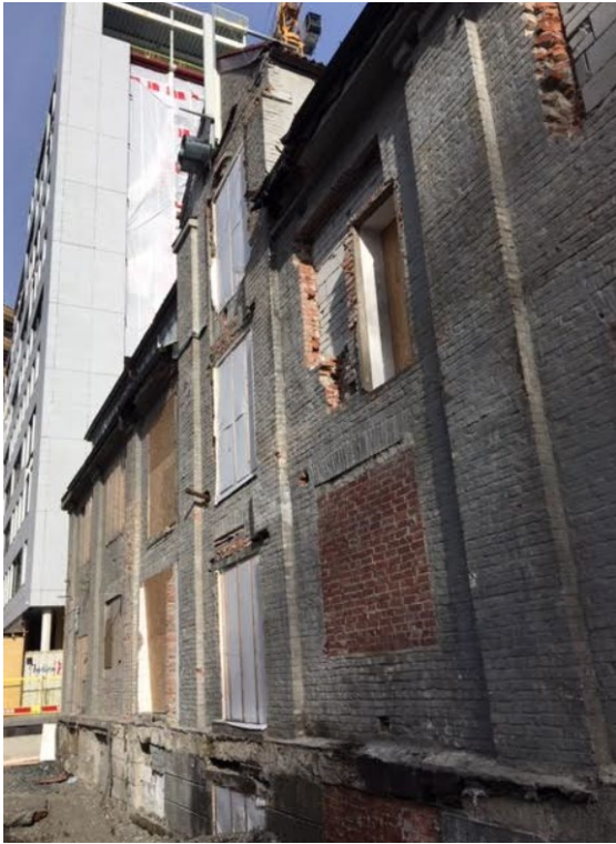
Teglfasade i dårlig skikk.
