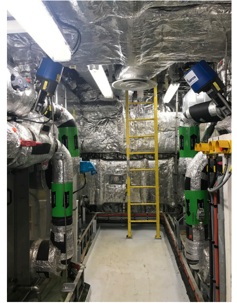
Ett av mange tekniske rom.
