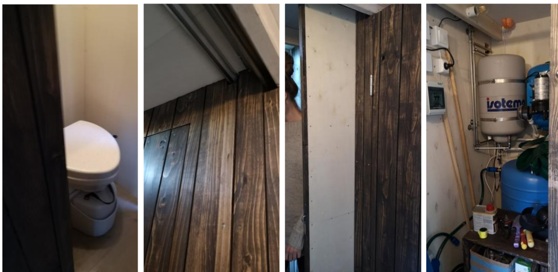
Viser toalett, uttrekkbar vegg til dusj og toalett sone. Samt teknisk rom. Bilde: Privat.
